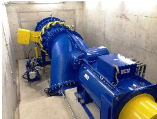
(東町・東新町公民館小水力発電所)
