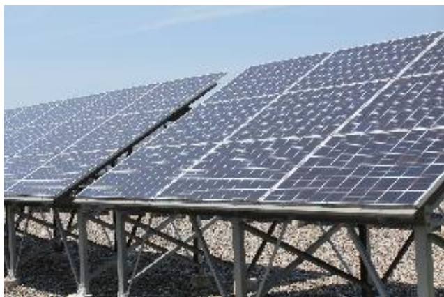
(富山太陽光発電所 太陽光パネル)
